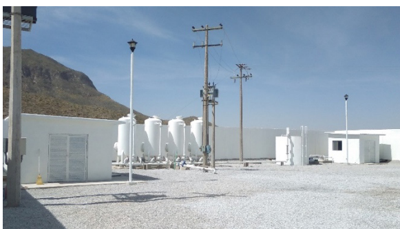
Imagen 5.2-A. Planta potabilizadora de filtración directa a presión del pozo Alamito en Francisco. I. Madero, Coahuila.
