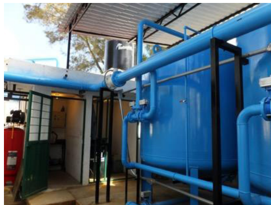
Imagen 5.6. Planta para la remoción de arsénico ubicada a un lado del tanque principal en la cabecera municipal
